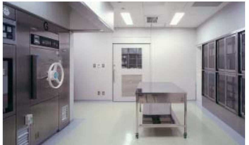
完備した中央材料室内の滅菌室（6階）
