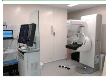
放射線検査室に設置されたマンモグラフィ撮影装置
