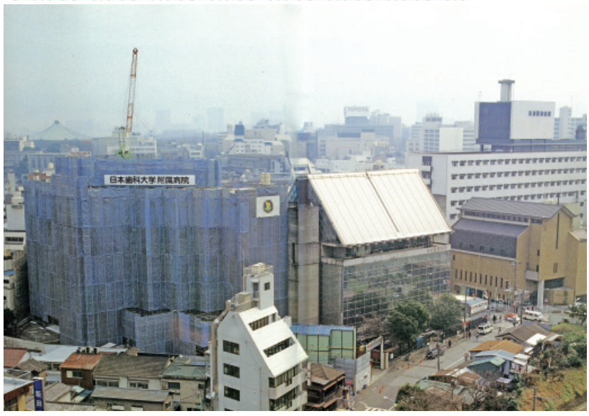
飯田橋駅西口・ラムラ住宅棟より九段方向、右に警察病院が見える現在、西口では再開発工事が進み、2014年には新しい環境が出現する
